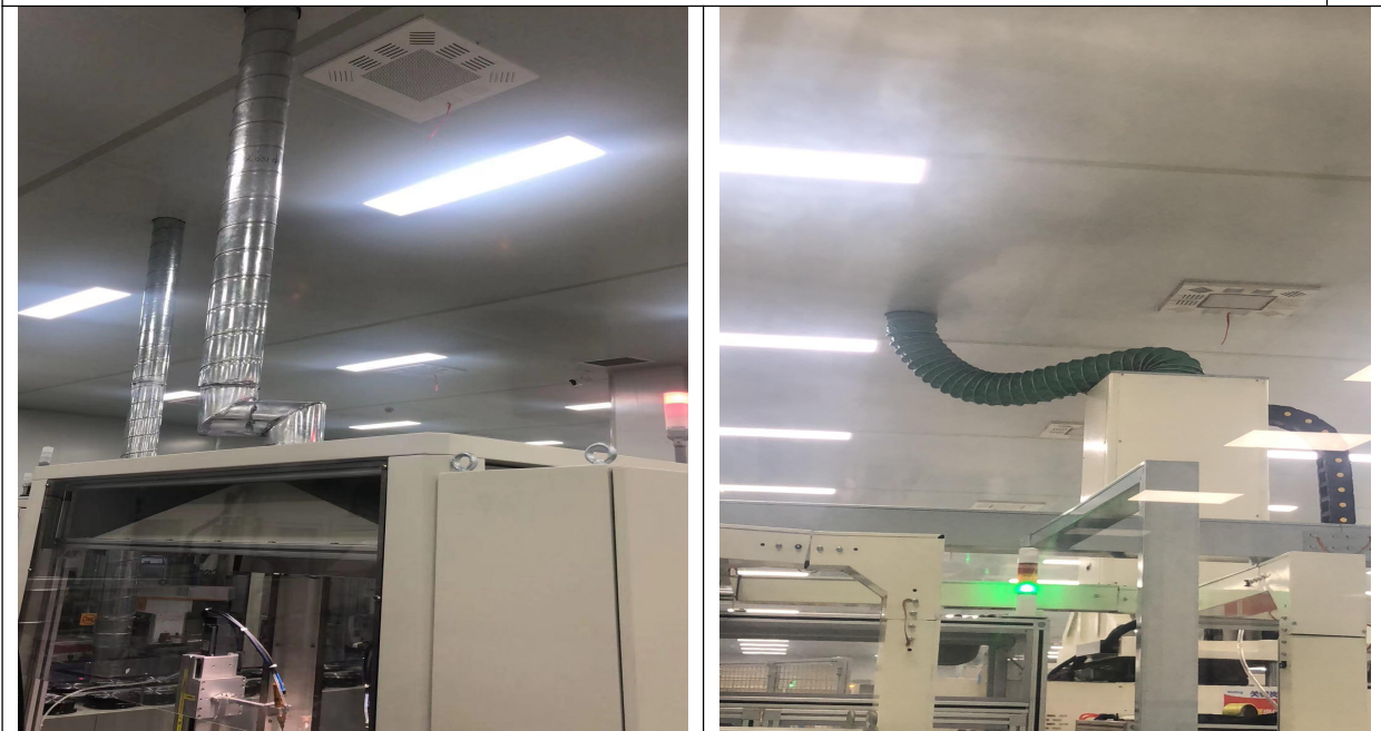
车间内部焊接废气集气系统
